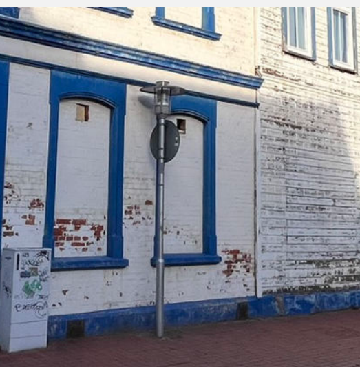
DIE SCHÄDEN AN GEBÄUDEN KÖNNEN UMFASSEND SEIN UND SIND NICHT IMMER AUF DEN ERSTEN BLICK SICHTBAR.
